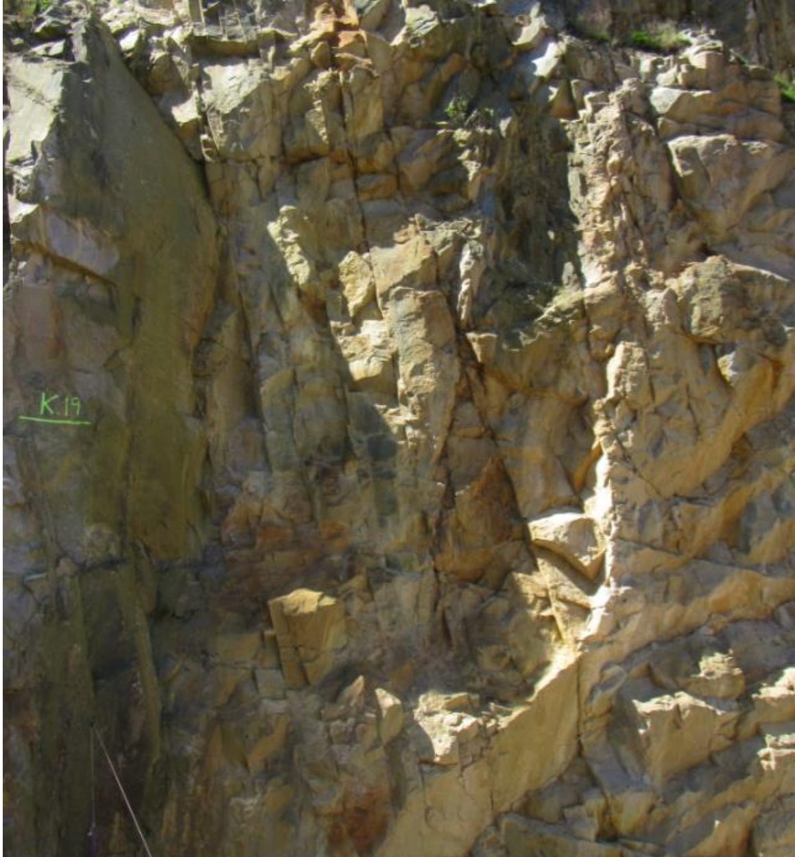
Fig. 6. Sprekker med grønt dekke (mest sannsynlig alger). På veggen er det markert kote 19, som tilsvarer ca. grensekoten for avsetninger rundt fjellet. Det er mistanke om at fukten som alene vokser i kommer fra regnvann siden det er en vertikal forandring i mengde alger. Horizontal vannmigrasjon er ikke sannsynlig.
